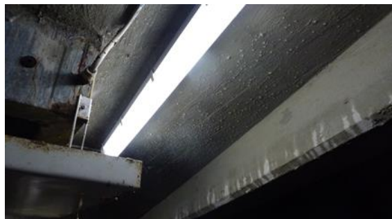
Figur 16: Vandtårn, kondens på loft i vandbeholder
