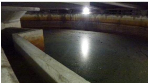
Figur 15: Vandtårn, kalkudfældning på vandoverflade
